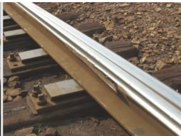
Obrázek 36 - odtržený převalek při zanedbání údržby
